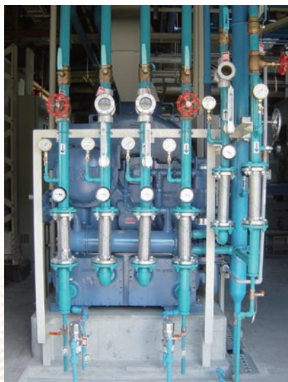
プラント配管設備
